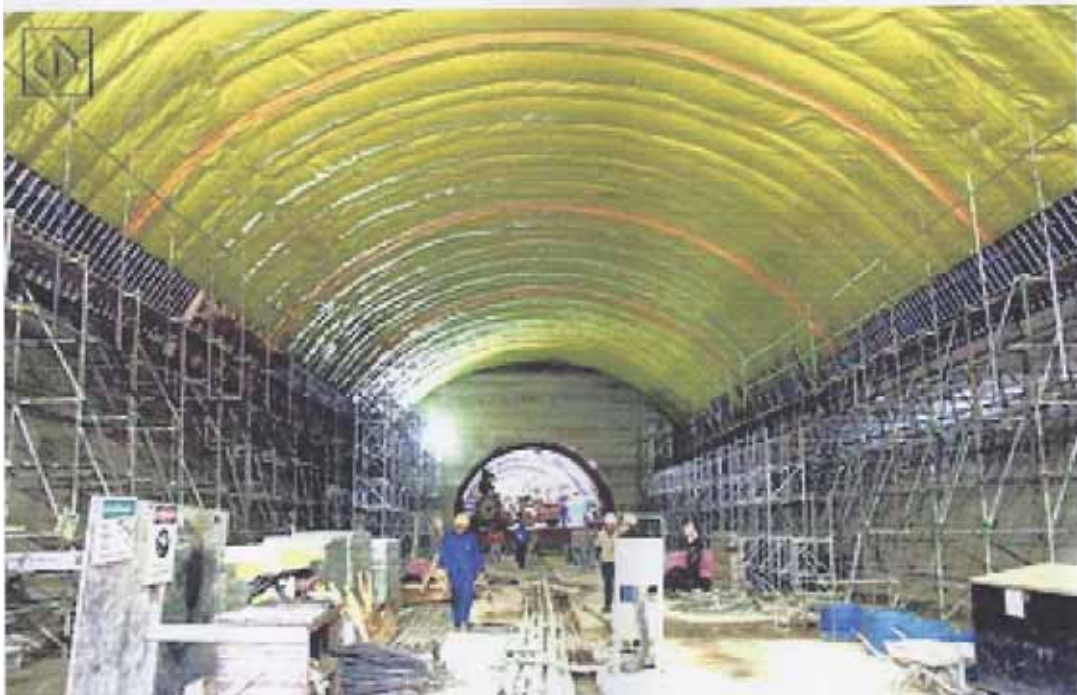
FOTO 22: Fase de execução do túnel de segunda fase, em amarelo a manta de impermeabilização.
