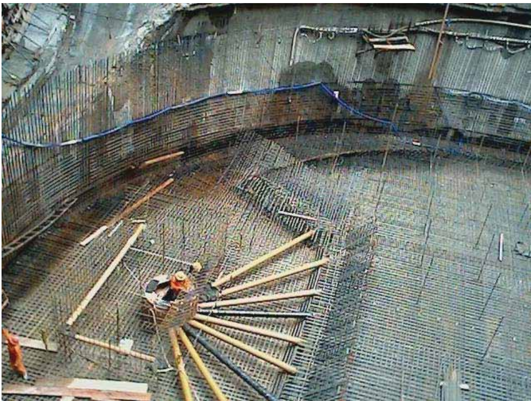
FOTO 23: Montagem da armadura da laje de fundo definitiva do poço de acesso.
