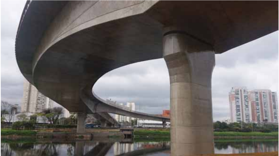
Foto 22 - Vista inferior do vão entre AP2 e AP3 (foto tirada do AP3 em direção ao AP2) [08/2016]
