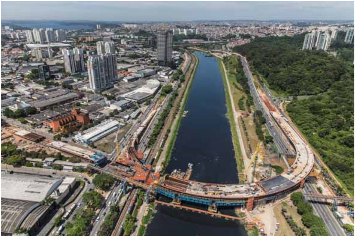
Foto 13 - Fases 1, 2, 4 e 5 - Finalizadas / Fase 3 - parcialmente executada / Fase 6 - em execução / Fase 7 - montagem de formas sobre o escoramento [10/2015]
