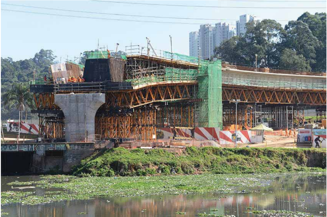
Foto 14 - Frente 1 - Fase 3 - Montagem de forma e armação da chegada dos ramos 100 e Ponte ao AP4 [06/2015]
